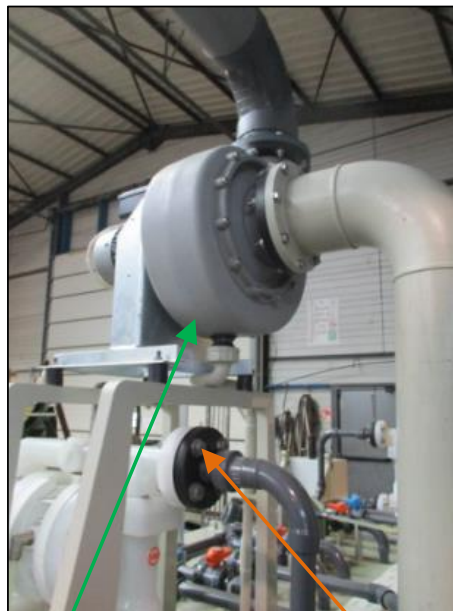
Ventilateur d'extraction avec récupération des condensats
