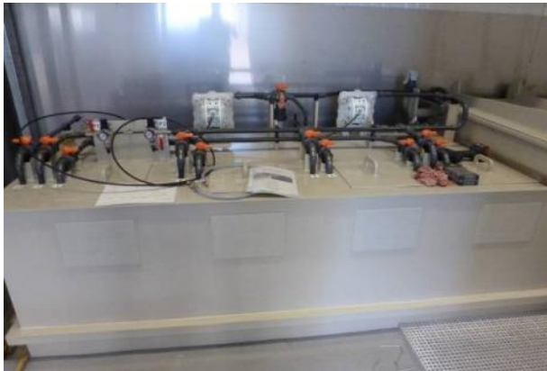
Cuves de stockage d'aspersion
