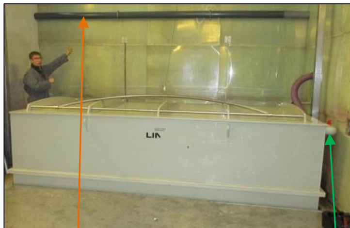
Conduit de rejet à l'extérieur et cuve avec bouche d'extraction
