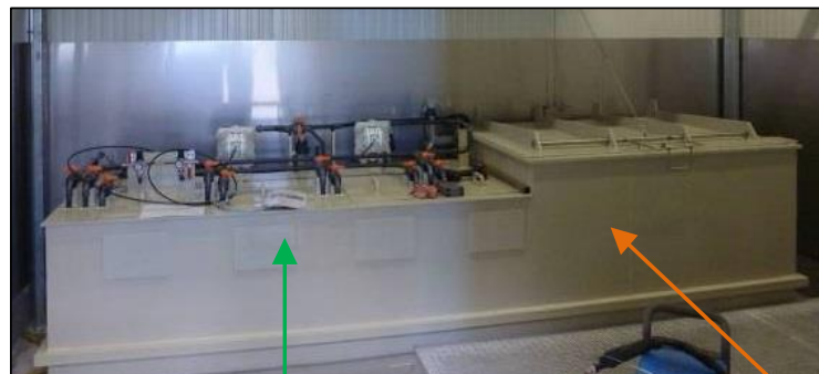
Cuves de stockage (à gauche) et cuve de traitement (à droite)
