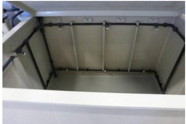
Cuve de traitement et rampes
