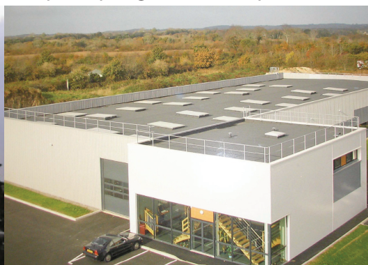
2 Acrotères de 1 à 1,10 m. de hauteur (ou garde-corps définitifs – fixes ou relevables)
