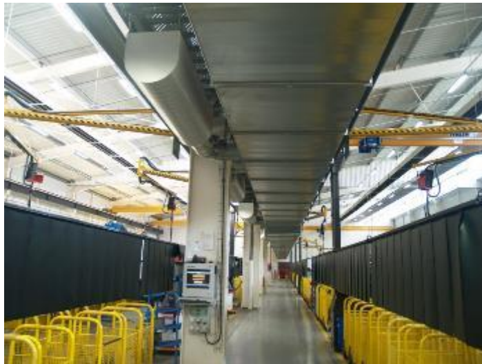
Caissons de diffusion d'air à basse vitesse positionnés au-dessus de l'allée centrale et extraction en partie haute de chacune des 2 nefes du bâtiment
